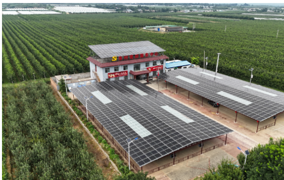
左图：安装棚顶光伏和屋顶光伏的耀州区小丘镇朱村党群服务中心；
